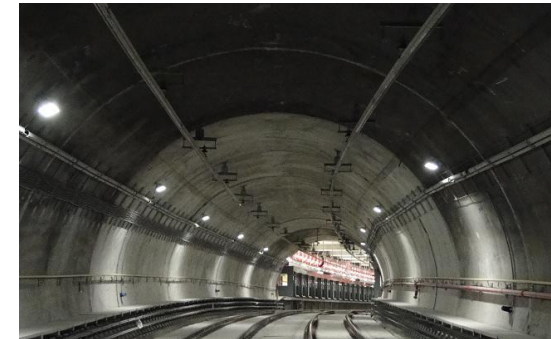
Контактная сеть в тоннелях
