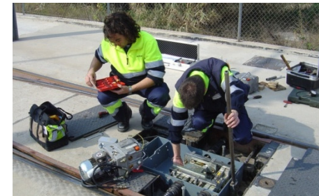
СЦБ, ERTMS level 2
